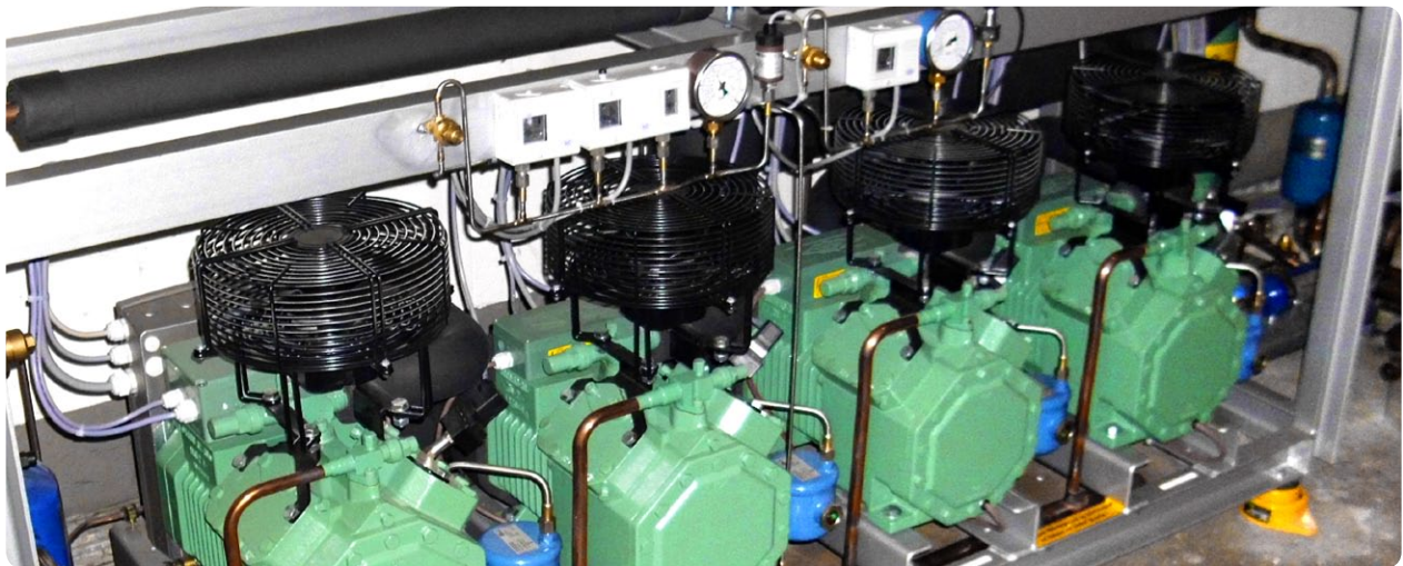
Tiefkühlverbundanlage reduziert Stromverbrauch um 14 Prozent oder 4.700 Euro pro Jahr
