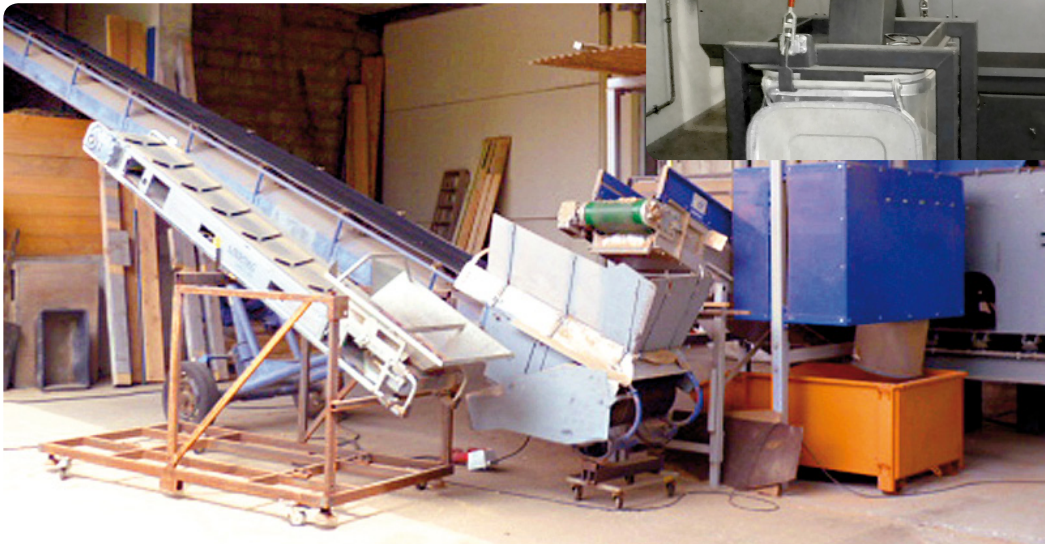
Aus dem Silo gelangen die Holzschnitzel automatisch in den modernen Holz-Brennkessel.
